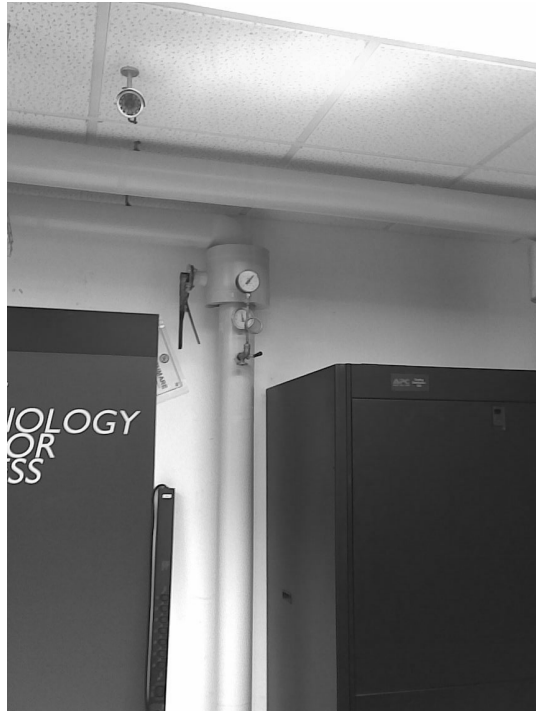
Fig. 8 – Particolare del sistema di video-sorveglianza.
